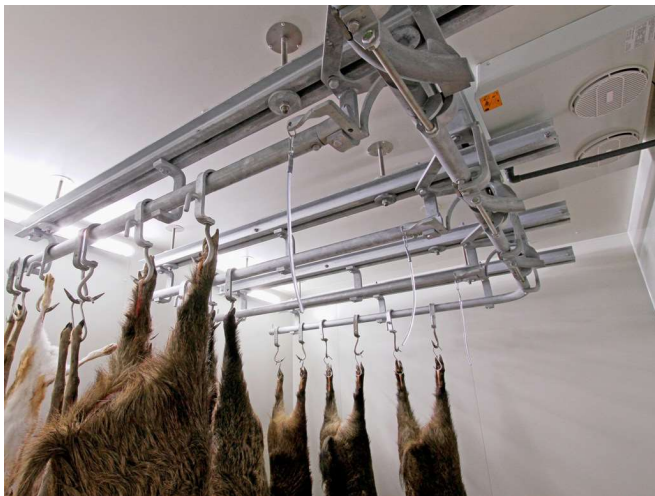
Die Rohrbahn muss statisch berechnet sein und regelmäßig gewartet werden
